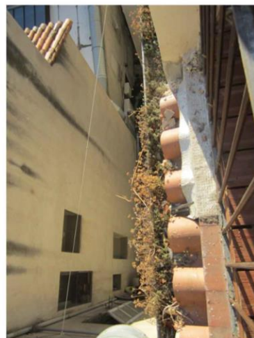
Gouttière façade arrière
