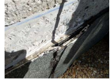
Étanchéité des terrasses à revoir
