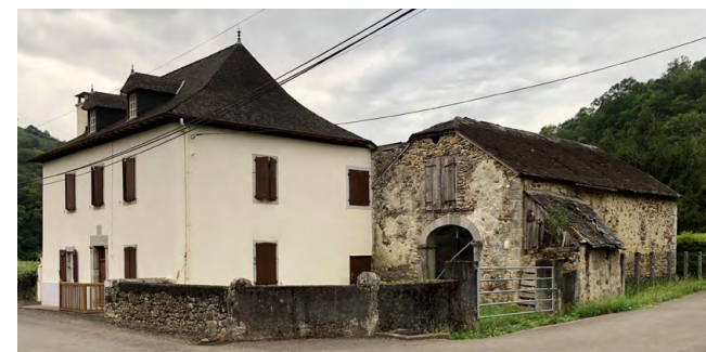
Avant travaux. Un bâtiment agricole très dégradé.
