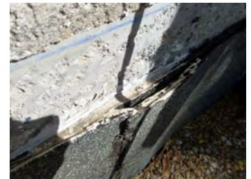
Étanchéité des terrasses à revoir
