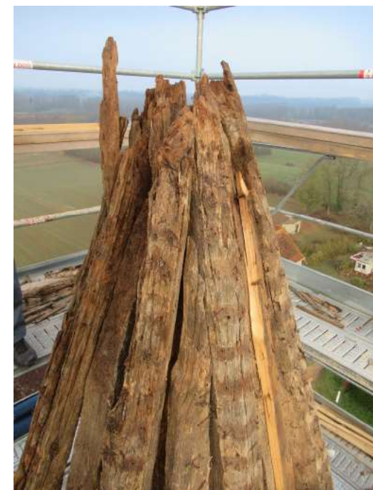
Pointe du clocher dégradée: complément de bois et renfort avant repose de la croix
